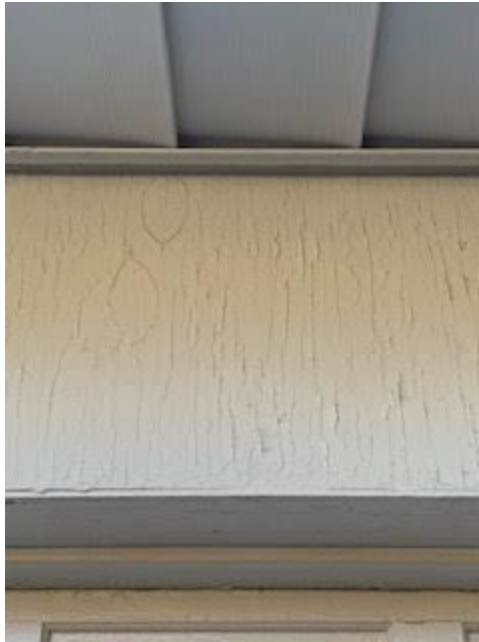
Fig. 4.12: Peeling paint on garage door header.
